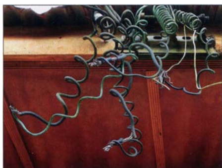
Lokale Lösung: improvisierte elektrische Leitungen
