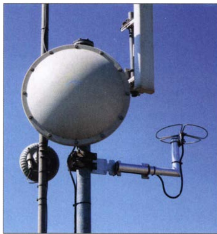
Antennen bei DB0DMO; für NPR ist das Big Wheel, rechts im Bild, zuständig.
